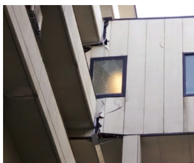
連絡通路の連結部分破損
