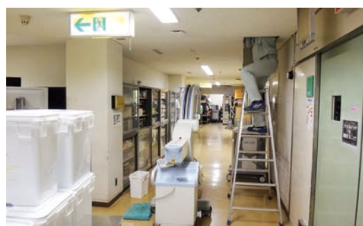
配管破損で蒸気漏れ
