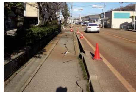
病院前の道路陥没が多数発生
