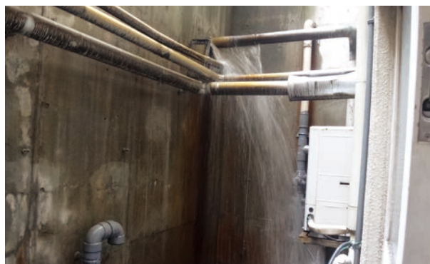
給水配管からの漏水
